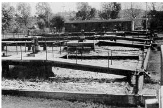
Foto 1: Tanques de aireación mediante turbo-agitadores / Pasarelas con ensanchamiento en la zona de accionamiento de agitadores
