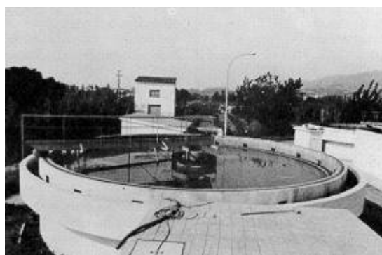
Foto 2. Balsa de decantación elevada con el acceso sin protección
